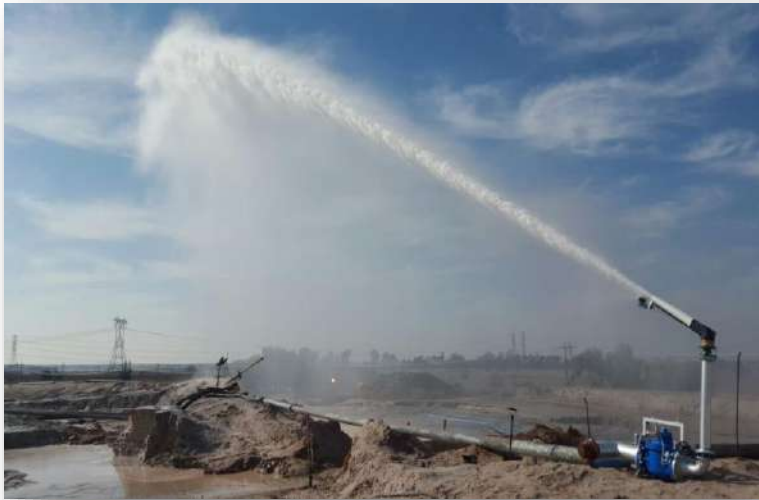
Water Canons – Dust Suppression
