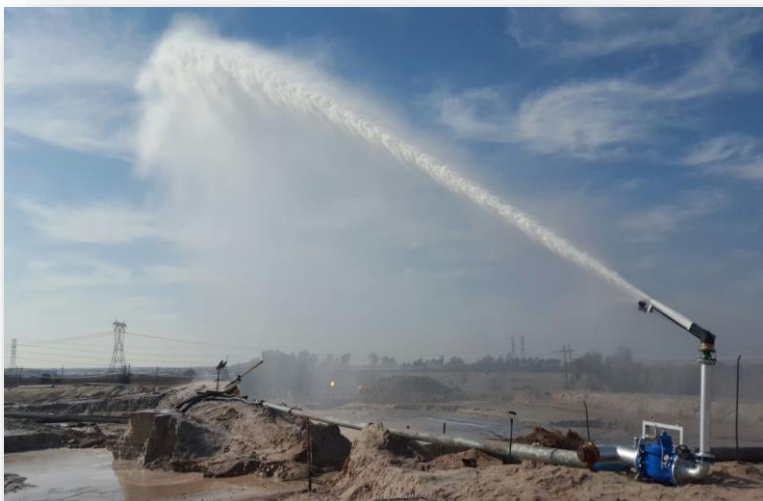
Water Canons – Dust Suppression
