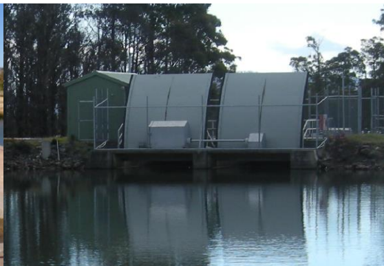
Figuur 4 | Voorbeeld van inlaatstruktuur met rommel-opvangere en sluise. (Source:www.ncwater.org.)
