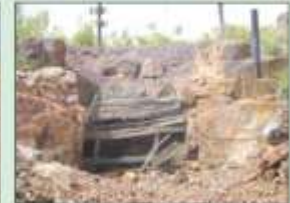
Figuur 4: Skag 3 in 'n vervalde toestand. Agter die houtbarkende breek die skag 'n diepte van bykans 70m.
