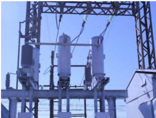
a. Existing 25kV feeders
