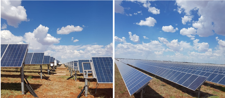
Figuur 1: FV-sonkragaanleg (met vergunning deur Building Energy South Africa (Edms.) Bpk.)
