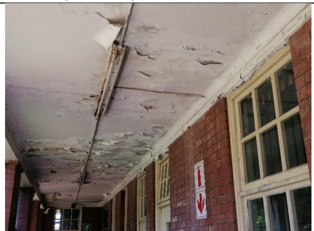
Passage : Ceiling damp
