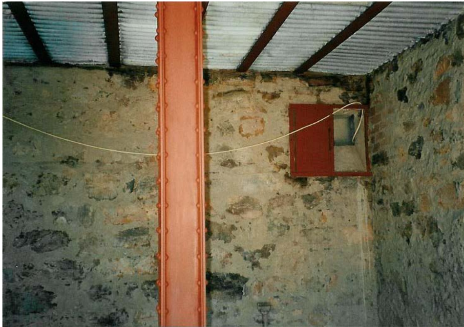
Figuur 37. Staalpilaar in die telegraafvertrek nadat dit met roesweerder behandel is.
