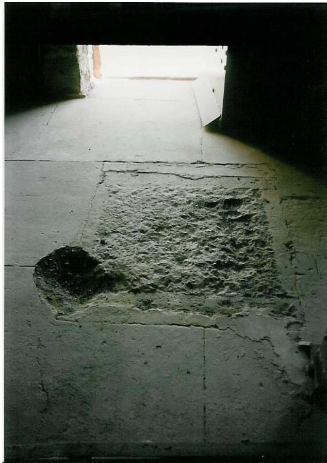
Figuur 41. Merke op die vloer in machine wat waarskynlik aandui waar die paraffienstelsel gestaan het.
