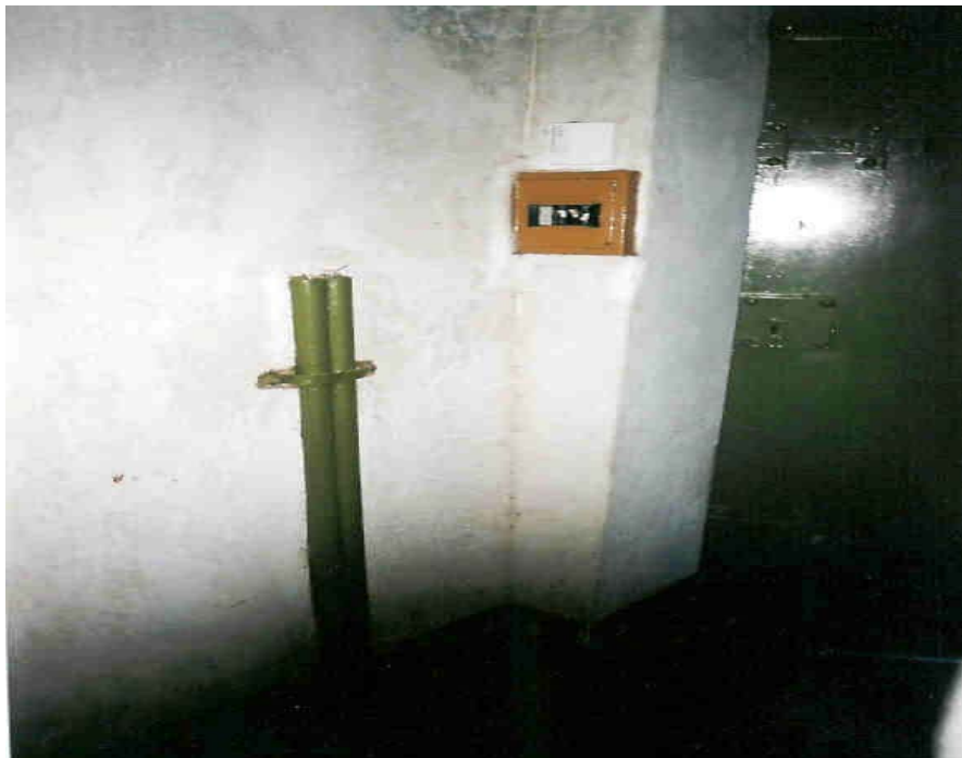
Figuur 29. Die groen pype is oorspronklike pype waarbinne die kragrade in die fort geloop het. Die bruin kragbord is 'n latere toevoeging.
