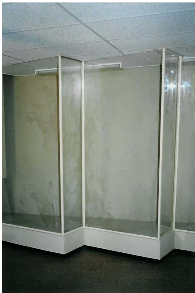
Figuur 65. Hierdie kaste, wat deur die SA-Weermag geïnstalleer is, is verwyder aangesien dit die mure verhinder het om asem te haal.
